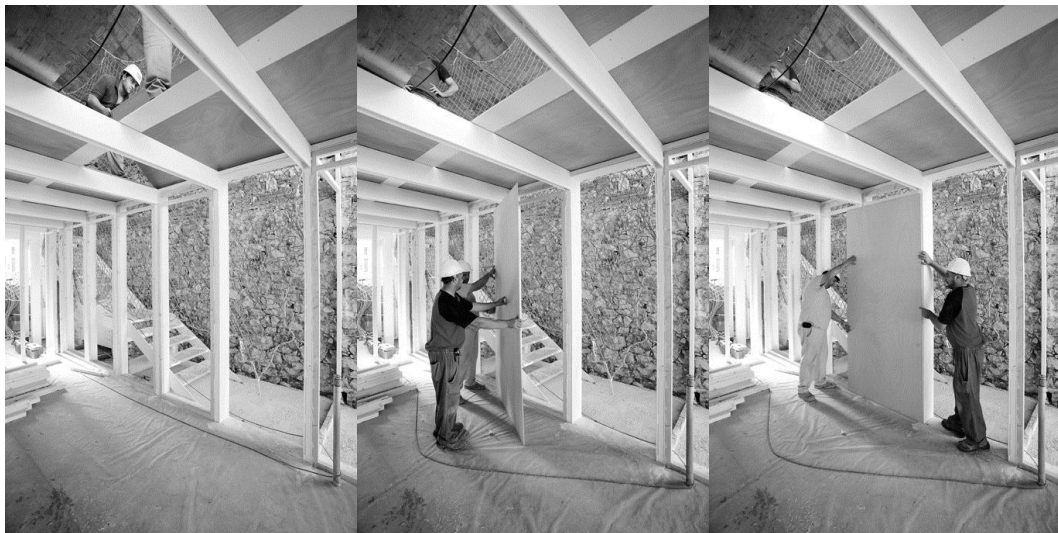
Fig. 24. Centre d'Art Cal Massó, construcció de la segona fase, zona altell d'oficines. Font: José Hevia
